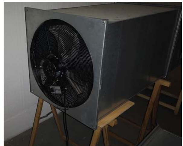
Foto 16: Acoplamiento ventilador doméstico.
