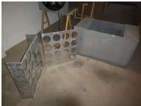
Foto 8: Rejilla de distribución
