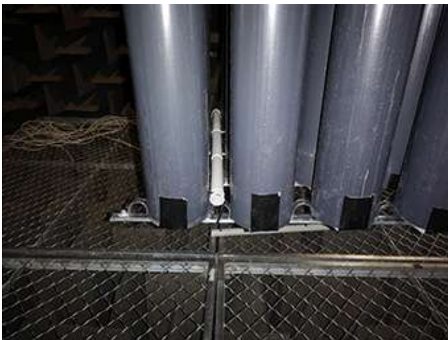
Foto 3: Separadores entre filas de tubos
