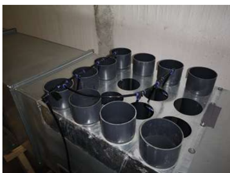
Foto 12: Difusores de agua
